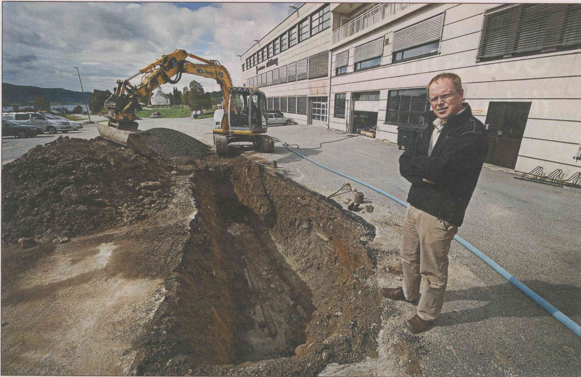
Uten vann: – Det er frustrerende med alle ledningsbruddene, sier adm.dir. Karsten O. Midthaug. For tredje gang på under ett år har det gamle eternittøret brutt sammen utenfor fabrikken til Brødrene Midthaug AS.
